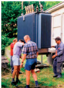
Umzug des 1000 kVA-Trafos von Trafostation Industrie nach Trafostation Dorf 1995
