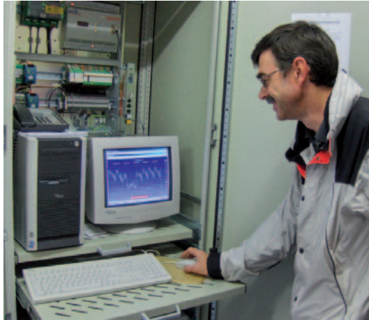
Modernste Technologie in der Trafostation Dorf (Digitale Rundsteuerungsanlage)
