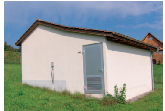
Heutige Trafostation Unterrüti
