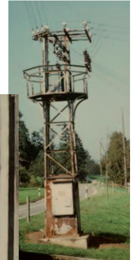
Trafostation Unterrüti vor Abbruch 1977
