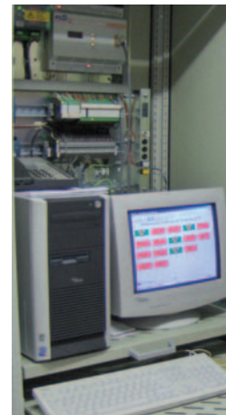
Modernste Technologie in der Trafostation Dorf
