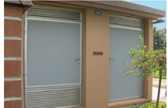
Heutige Trafostation Hagnau
