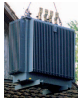
1000 kVA-Transformator, der in die Trafostation Dorf gezügelt wurde.
